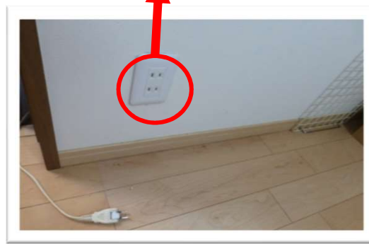
コンセント付近カビ発生
