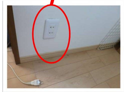
コンセント付近カビ発生
