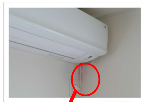
エアコンコンセント周りカビ
